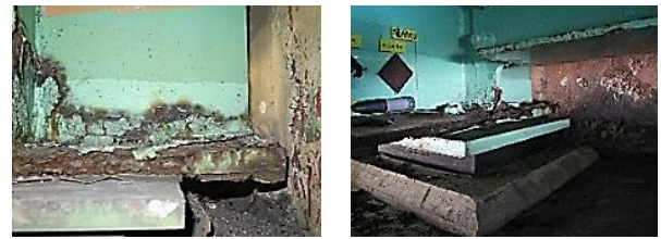
写真-1 桁端部が腐食した鋼橋
