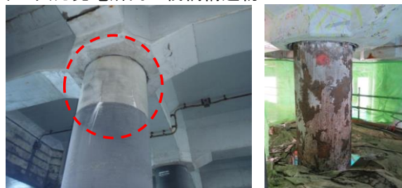
(a) 剥離損傷例 (b) 内部の腐食状況例
