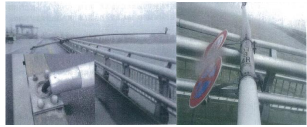
図-1 台風により倒壊した照明柱
