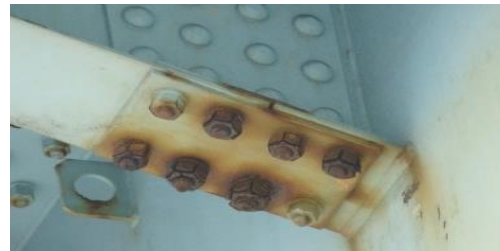
写真1 高力ボルト継手部の腐食損傷事例
