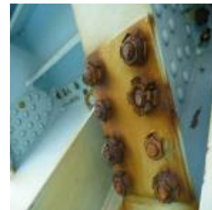
写真 1 高力ボルトの腐食状況
