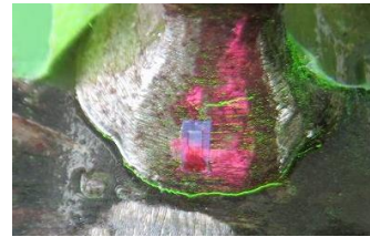
写真 1 溶接継手部に発生する疲労き裂
