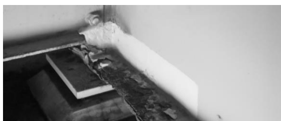
図1 桁端部腐食状況
