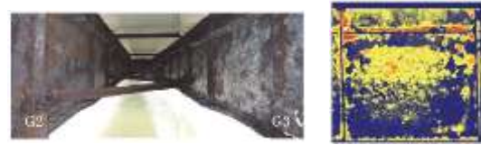
図-1 桁端部の腐食状況と腐食分布
