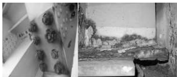
写真-1 腐食した高力ボルトと桁端部
