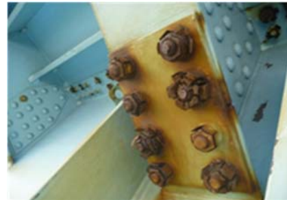
写真 1 腐食高力ボルト
