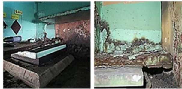
写真-1 桁端部が腐食した鋼橋
