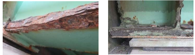
写真-1 腐食した鋼橋桁端部
