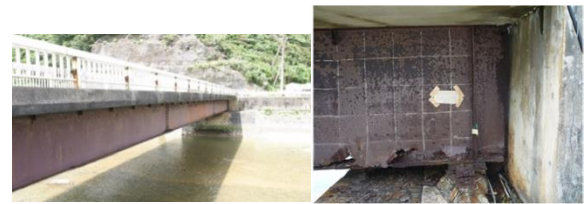
鋼プレートガーター橋 ウェブと下フランジの破断 写真 1-1 鋼桁端部の腐食事例
