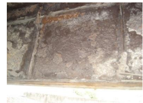
写真 1.2 内面の腐食形状
