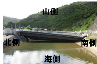
写真 1.1 崩落後の破壊状況
