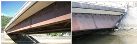
(a) 対象橋全景 (b) 崩落
