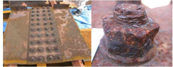
(a) 継手部 (b) 腐食ボルト
