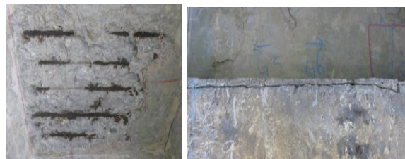
写真1. 塩害によるコンクリート橋のひび割れ
