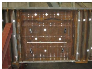
2. ウェブ初期変形 3. ウェブ腐食残存板厚
