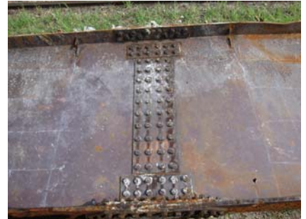
写真1 崩落橋から回収した継手
