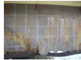
図-1 崩落前の辺野喜橋桁端部
